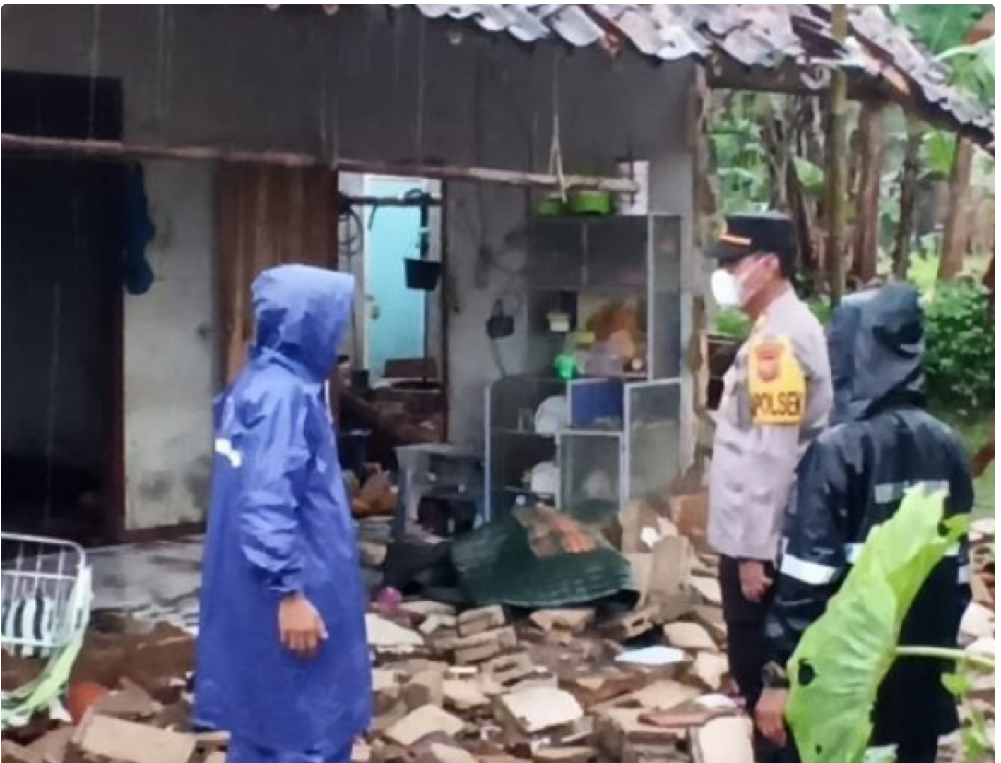
Akp Deden Sulaeman: 50 Rumah Alami Kerusakan Akibat Angin Puting Beliung
